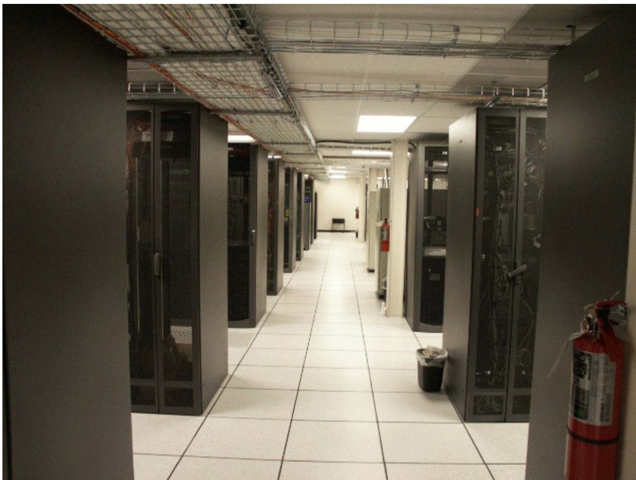
Un datacenter. On voit ici plusieurs baies de serveurs.
