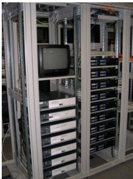
Une baie de serveurs
